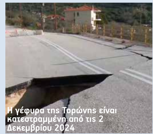
Η γέφυρα της Τορώνης είναι κατεστραμμένη από τις 2 Δεκεμβρίου 2024
